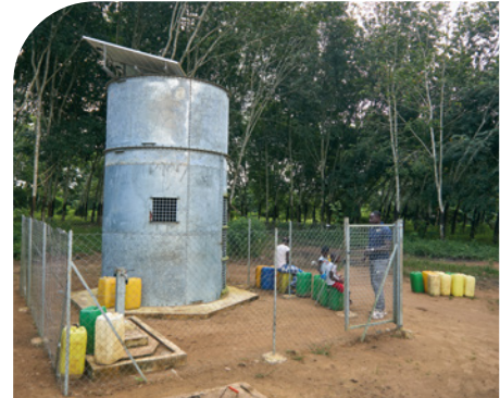
Point d'Eau Autonome (PEA) : château d'eau et pompage solaire
