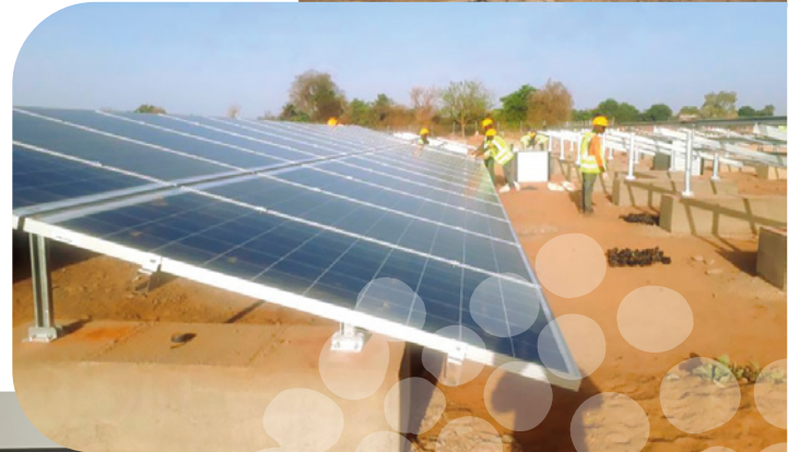
Centrale solaire au Burkina Faso
