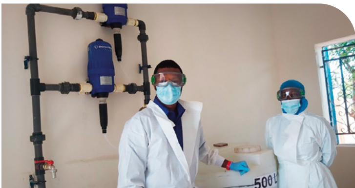
Chloration en ligne
