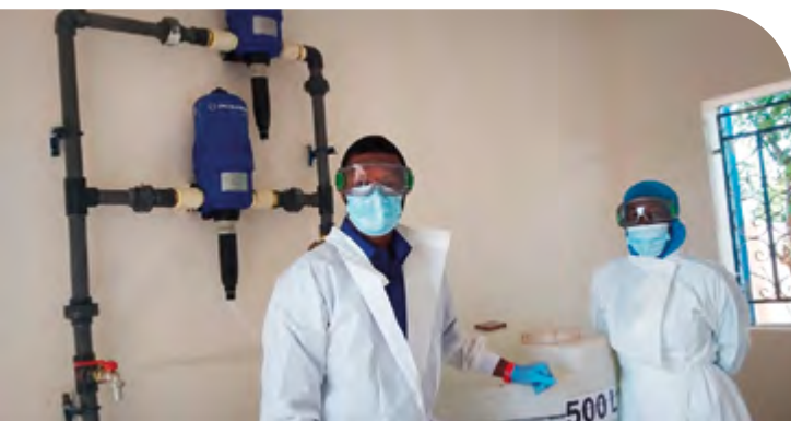
Chloration en ligne
