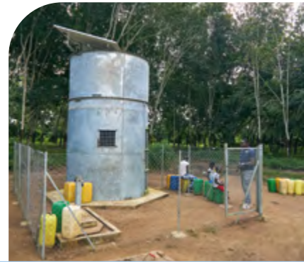
Point d'Eau Autonome (PEA) : château d'eau et pompage solaire
