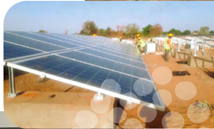
Centrale solaire au Burkina Faso
