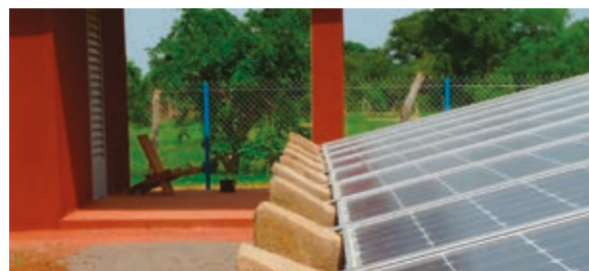
Photographies d'un champ solaire mis en place par VERGNET HYDRO, MTCS et ATC MALI en 2011 au Mali pour un projet de 11 centres hydrauliques, similaires aux 20 centres évoqués ci-dessus.
