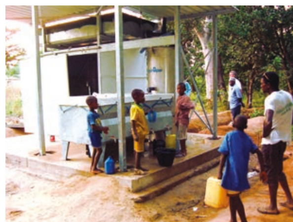
Villageois s'approvisionnant en eau potable auprès d'une station de traitement HYDROPUR®, en Guinée.
